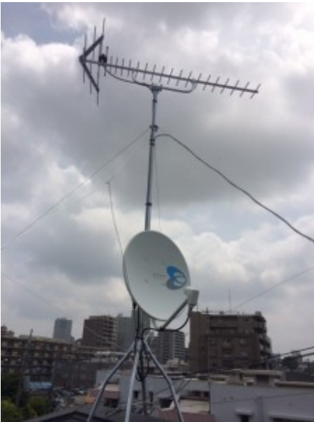
無線LANの設置
