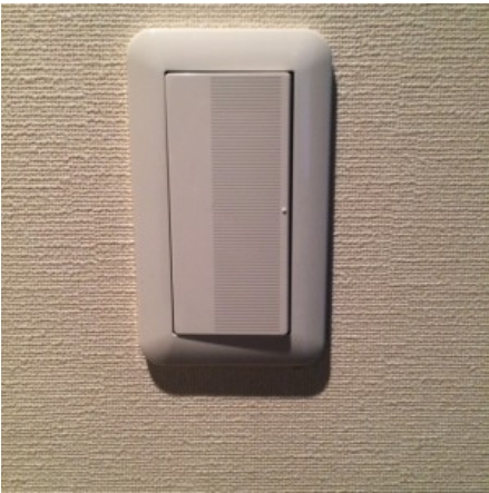
無線リモコンで電灯を操作する
