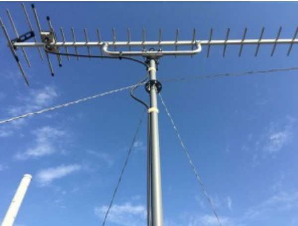
無線LANの設置場所
